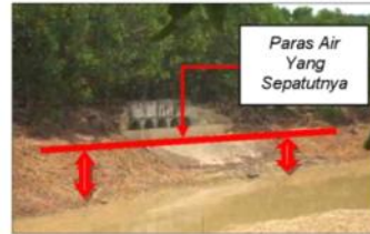
Kawasan NFCorp - Paras Air Menjadi Cetek Di Kolam Takungan Akibat Benteng Runtuh (08.03.2011)
