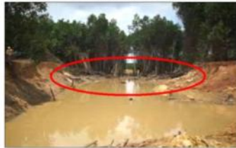
Kawasan NFCorp - Benteng Runtuh Akibat Banjir (08.03.2011)
